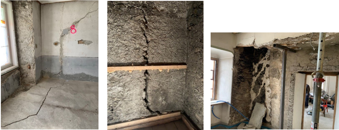
Die Schäden entlang der Fassade
